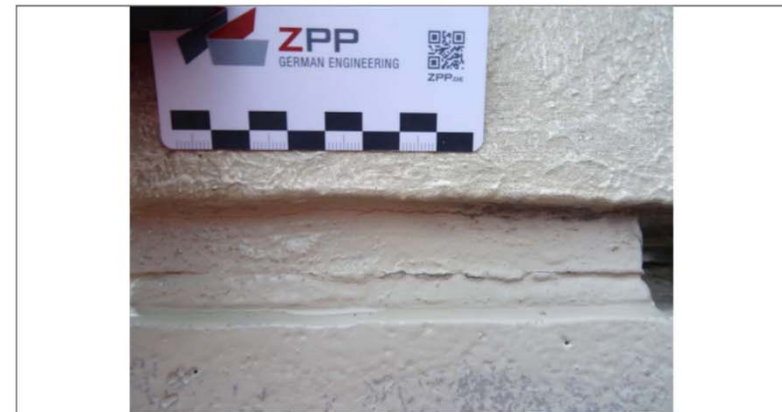
Foto 7: Risse in der Beschichtung im Bereich der Neoprenkissen
