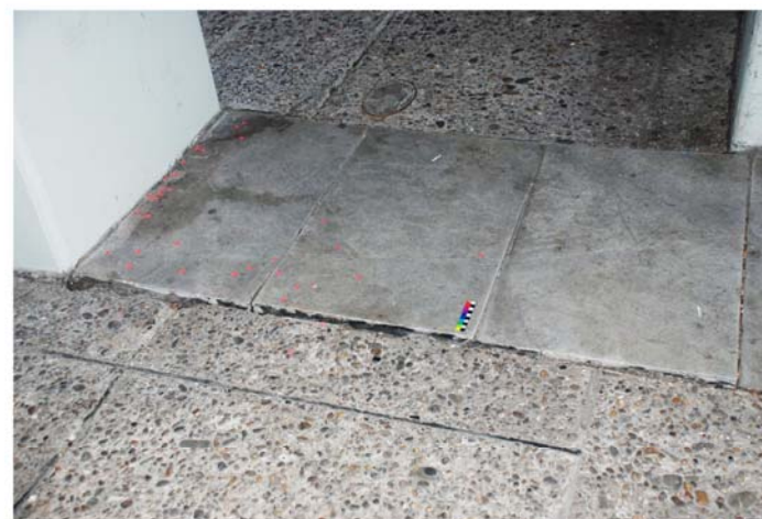
Abb. Ma 54 Sitzungstrakt, Außenbereich EG: Verworfenen Plattenbelag
