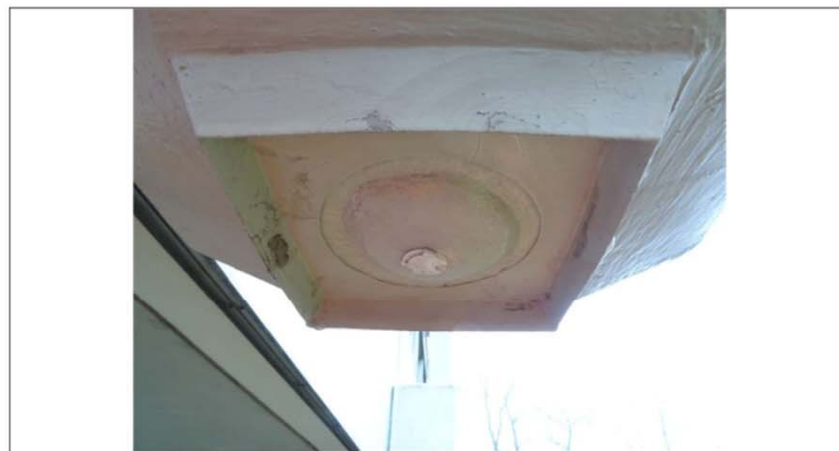
Foto 6: Beschädigung in der Beschichtung an einer Abtropfkante
