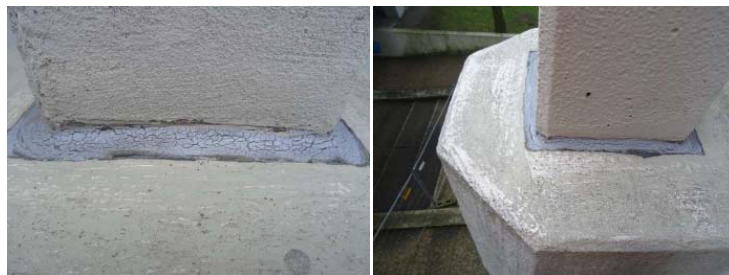
Abbildung 5: Netzartige Risse im Abdichtungsmaterial, Verformungen des Materials im Füllspalt
