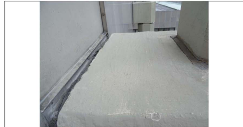
Foto 11: Abdichtung der Balkenköpfe und der Gebäudefassade, hier schadhaft
