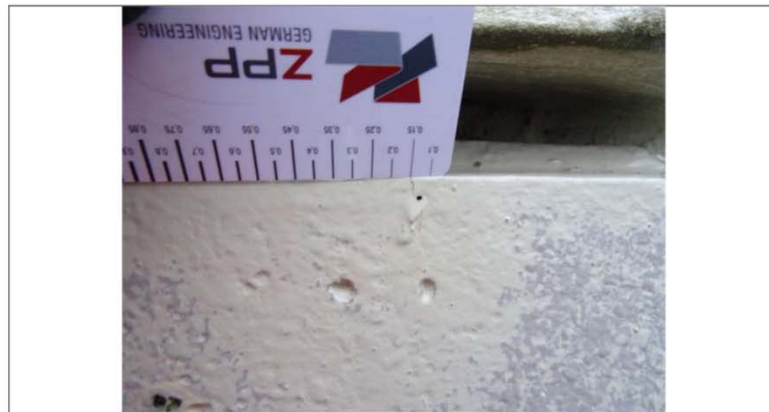
Foto 5: Riss in der Beschichtung
