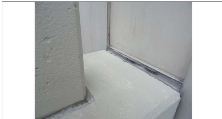
Foto 10: Abdichtung der Balkenköpfe und der Gebäudefassade, hier schadhaft
