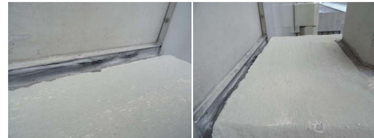
Abbildung 6: Schadhafte Abdichtung zur Gebäudefassade
