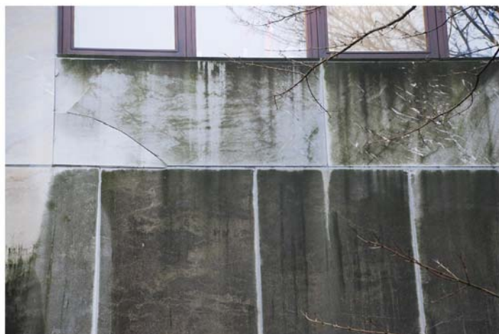
Abb. Ma 38 Sitzungstrakt Außenbereich: Oberflächenverschmutzung, Ansiedelung von Algen, Brüche Hier auch erkennbar die fungizide Wirkung der Verfugung respektive verringerte Wasseraufnahme in den Randbereichen der Fugen
