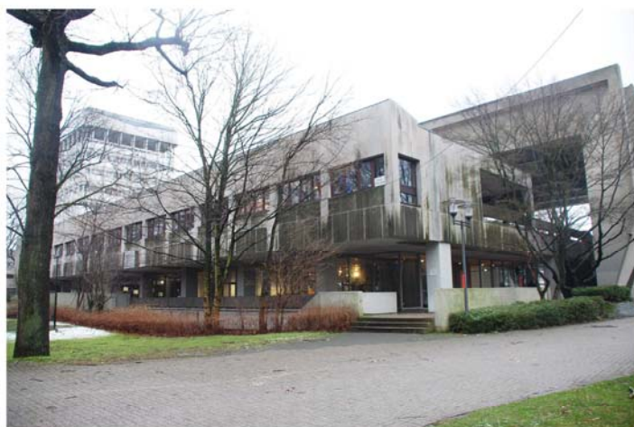
Abb. Ma 37 Sitzungstrakt Außenbereich: Oberflächenverschmutzung, Ansiedelung von Algen
