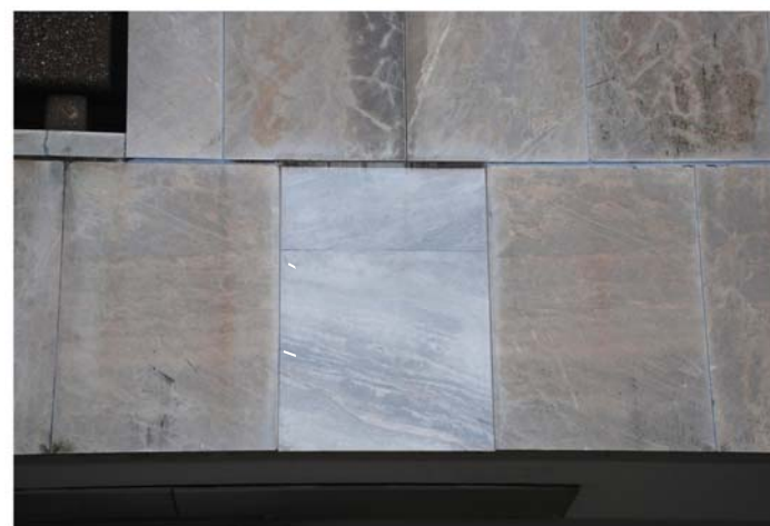
Abb. Ma 53 Sitzungstrakt: ausgetauschte Platte, Versagen der Vorhangkonstruktion
