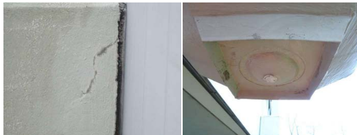
Abbildung 4: Riss in der Beschichtung und Abplatzungen an der Abtropfkante (exemplarisch)
